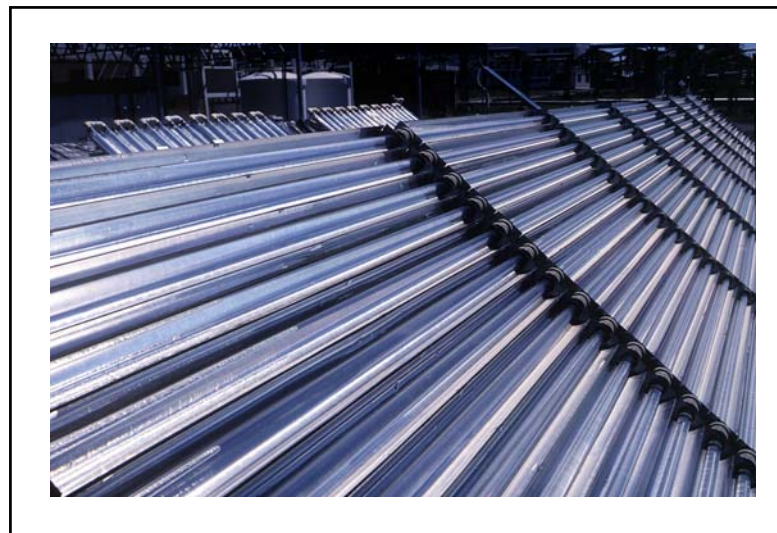
Fig 1.6 – Colector CPC de la Plataforma Solar de Almería donde se observa la configuración de los tubos reactores. Fotografía tomada por Carlos Bertrán.
