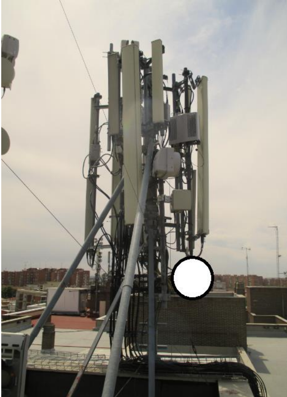
Figura 52. Equipos instalados en el emplazamiento existente donde se instalaría la nueva antena del radioenlace
