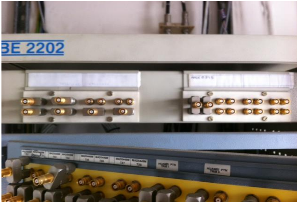
Figura 18. Repartidores ópticos y eléctricos de la compañía Nokia
