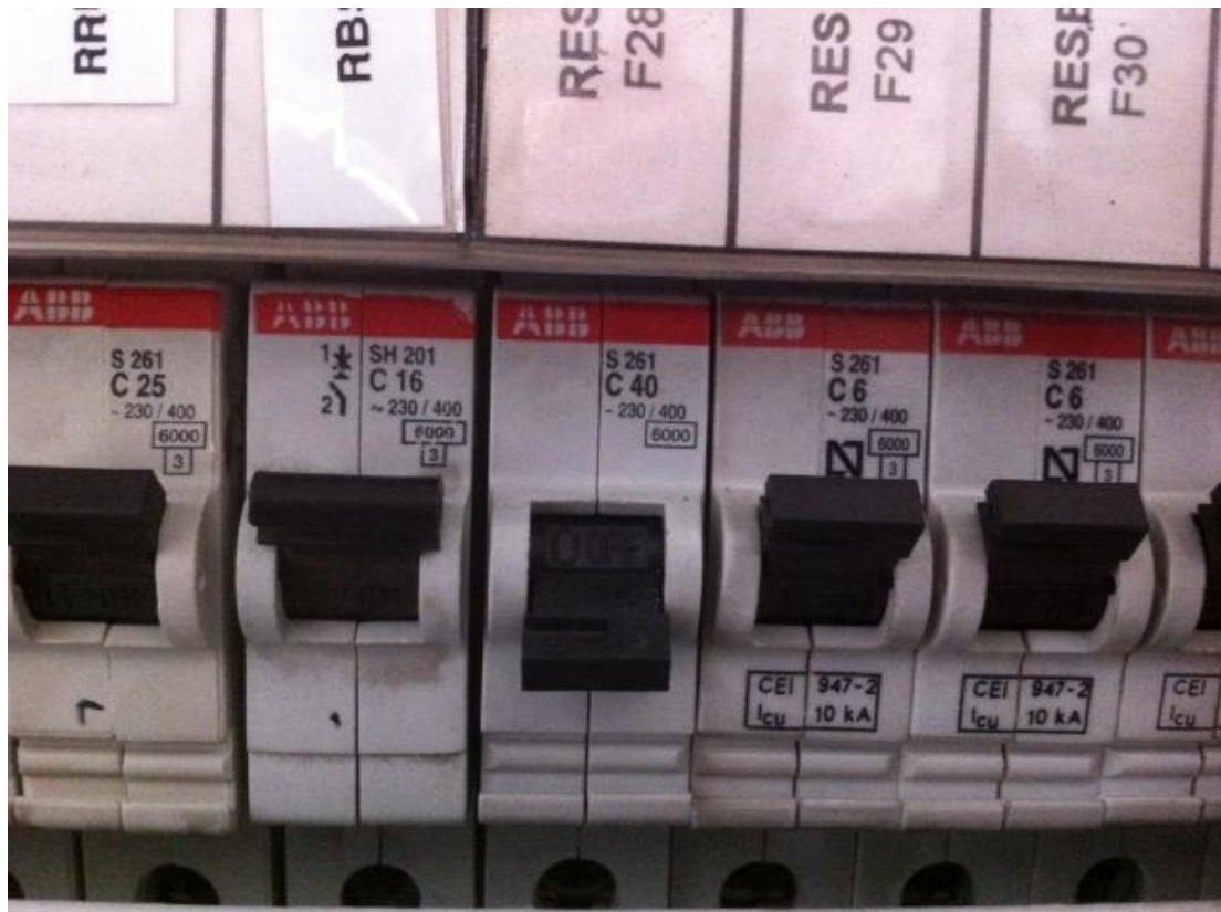
Figura 19. Conjunto de disyuntores instalados en el emplazamiento
