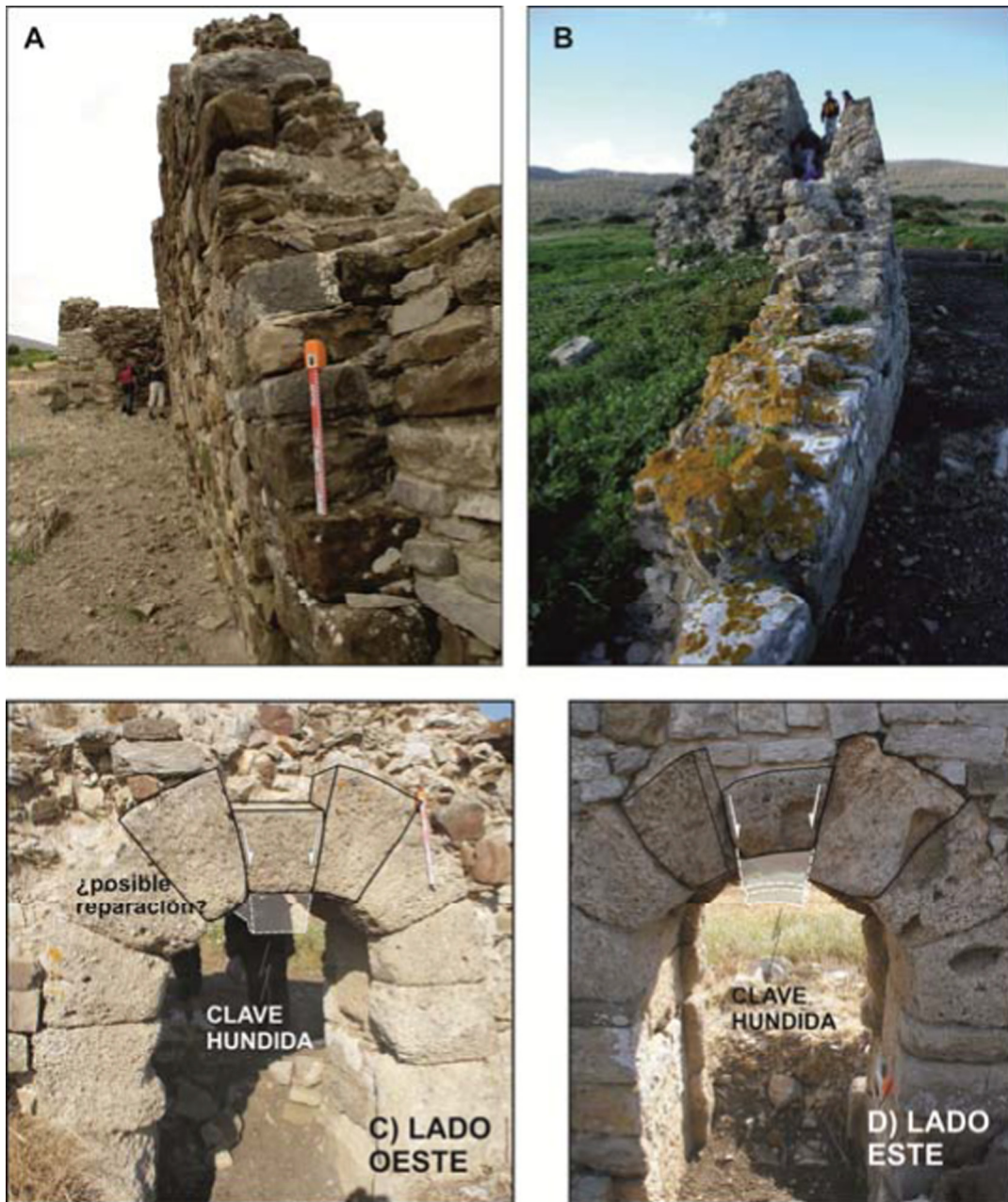
Fig. 6.—Aspecto de los bascamientos y desplazamientos de la muralla de la ciudad provocadas por el terremoto del 40-60 AD. A) Muralla este de la ciudad en la zona del Bastión Norte; B) Bascamiento de la Muralla oeste de la ciudad en la zona baja del Teatro; C y D Estructura de reparación de daños producidos por el terremoto del 40-60 AD en una zona de la muralla oeste de la ciudad (efecto post sísmico constructivo) como consecuencia del hundimiento de la clave central del arco en la puerta de uno de los bastiones de la zona este de la muralla. Las fotos muestran la estructura de reparación vista desde el interior de la ciudad desde el exterior de la misma.
