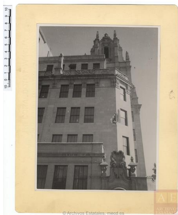
Figura 127: Fachada de la Telefónica que da a Valverde, en la que se puede apreciar los efectos de un obús.
