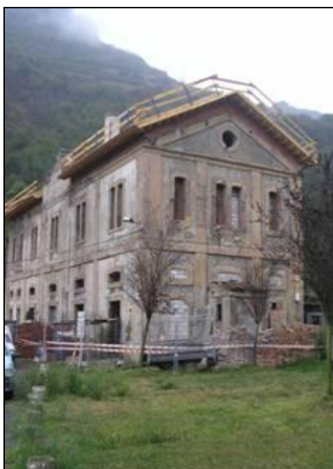
Figura 3. Ejemplo del deterioro del patrimonio arquitectónico del Poblado Minero de Bustiello del antiguo casino
