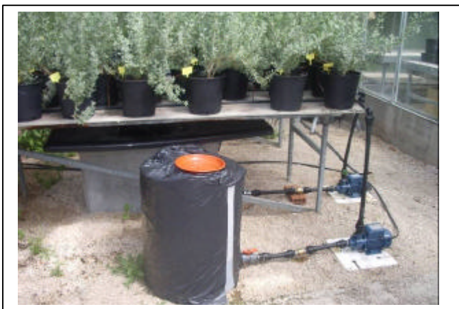
Fotografía 12: Tanque 3 del ácido cítrico y bombas centrífugas del sistema de riego.
