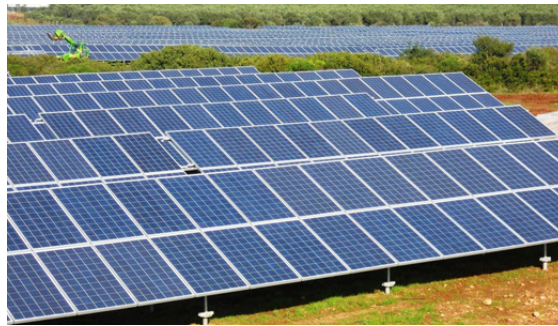
Figura 2.1.3: Planta de energía fotovoltaica.
