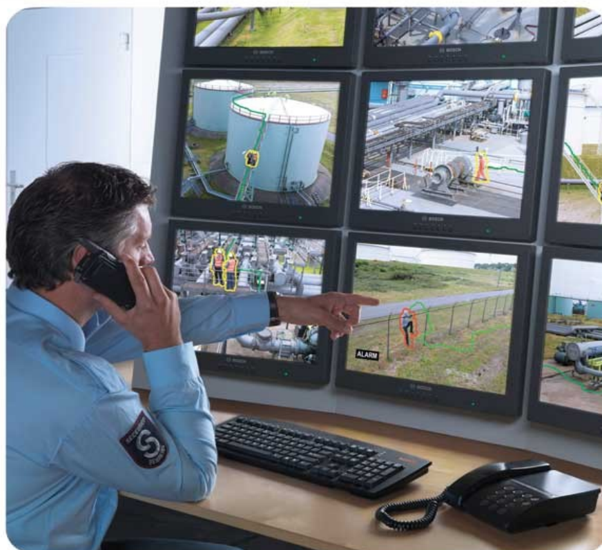
Figure 2-7: Videowall de un sistema con detección de movimiento
