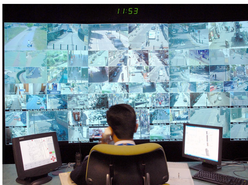
Figure 2-6: Videowall controlado por operador
