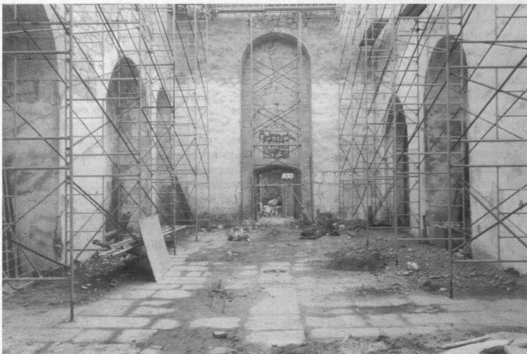
Fig. 3.- Perspectiva de la Capilla en dirección a la cabecera. En el centro del nicho de la Crucifixión la puerta abierta con posterioridad para dar acceso a la capilla.
