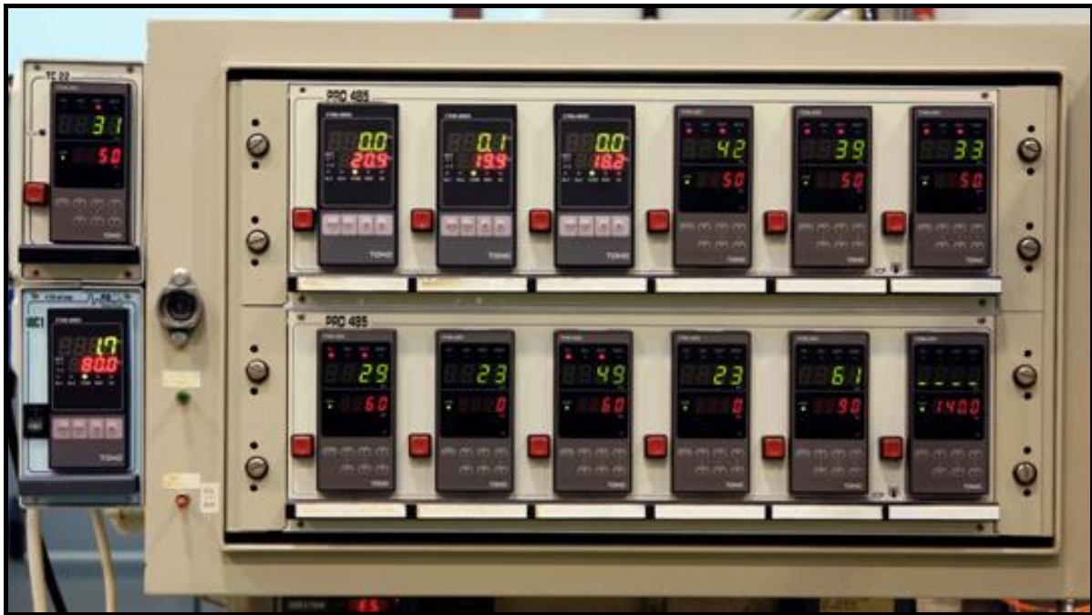
Figura 72. Panel de controladores TOHO para controlar las variables temperatura y presión de las diferentes partes del sistema.
