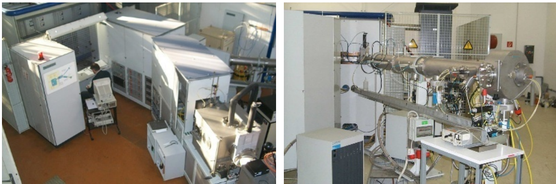
Figura 2.10: Instalación del implantador de media energía en el FZD.
