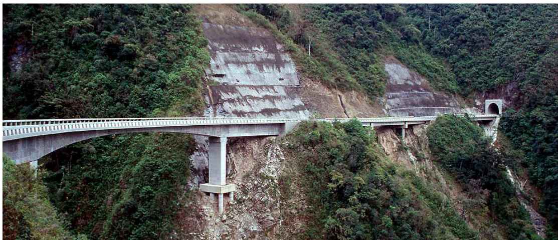
Foto 4.9 Viaducto y túnel de la nueva carretera en el área de Socosani
