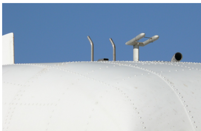
(b) Tomas de muestras y sensores instalados en la trampa de emergencia
