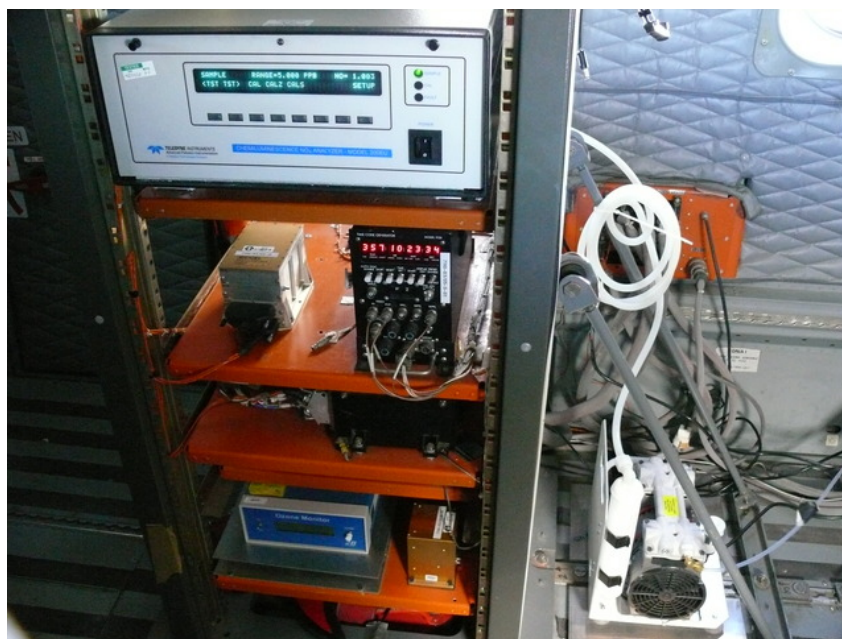
Figura 4.5: Monitor de ozono portátil 2B-202 (instrumento azul) instalado en la parte inferior de uno de los rack a bordo de la cabina de la plataforma aérea
