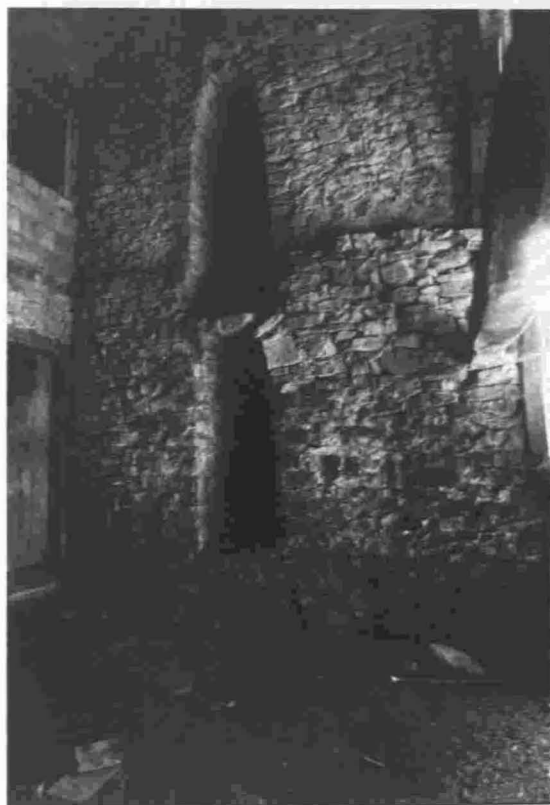
Estado actual de una de las paredes del horno de Ortiz de Zárate en Ollerías (Elosu).
