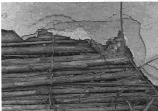
Detalle del encañizado del muro, con el revoc y diversas capas de cal con azulete. Foto de la autora.
